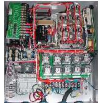
Vista interior controlador
