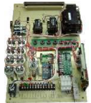
Vista interior controlador
