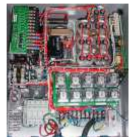
Vista interior controlador
