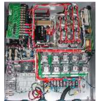
Vista interior controlador
