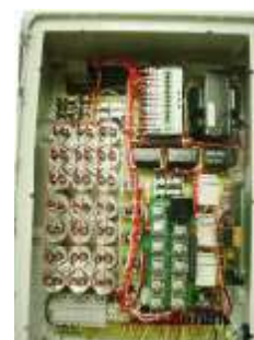
Vista interior controlador
