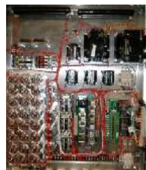
Vista interior controlador
