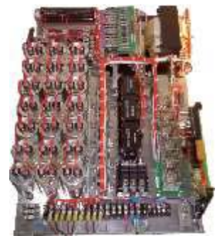
Vista interior controlador
