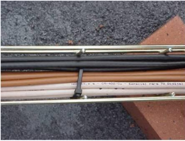
Grapas y canalización
