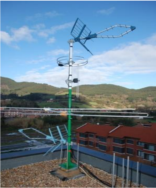
Elementos de captación
