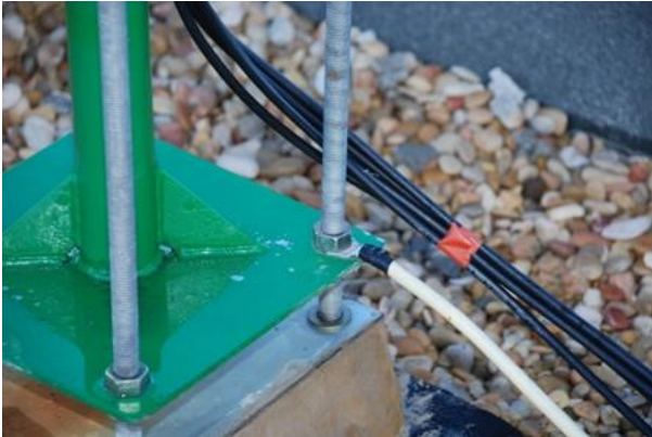
Conexión a tierra de un mástil
