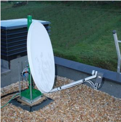
Elementos de captación satélite
