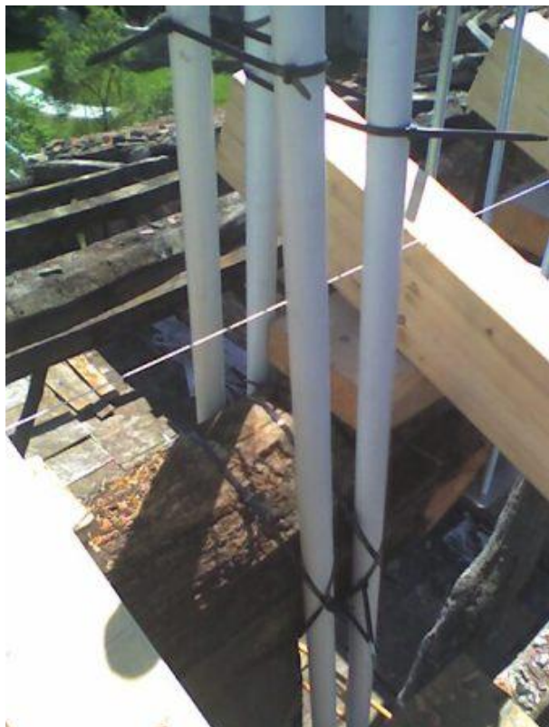
Vista de los 4 compartimentos de la canalización
