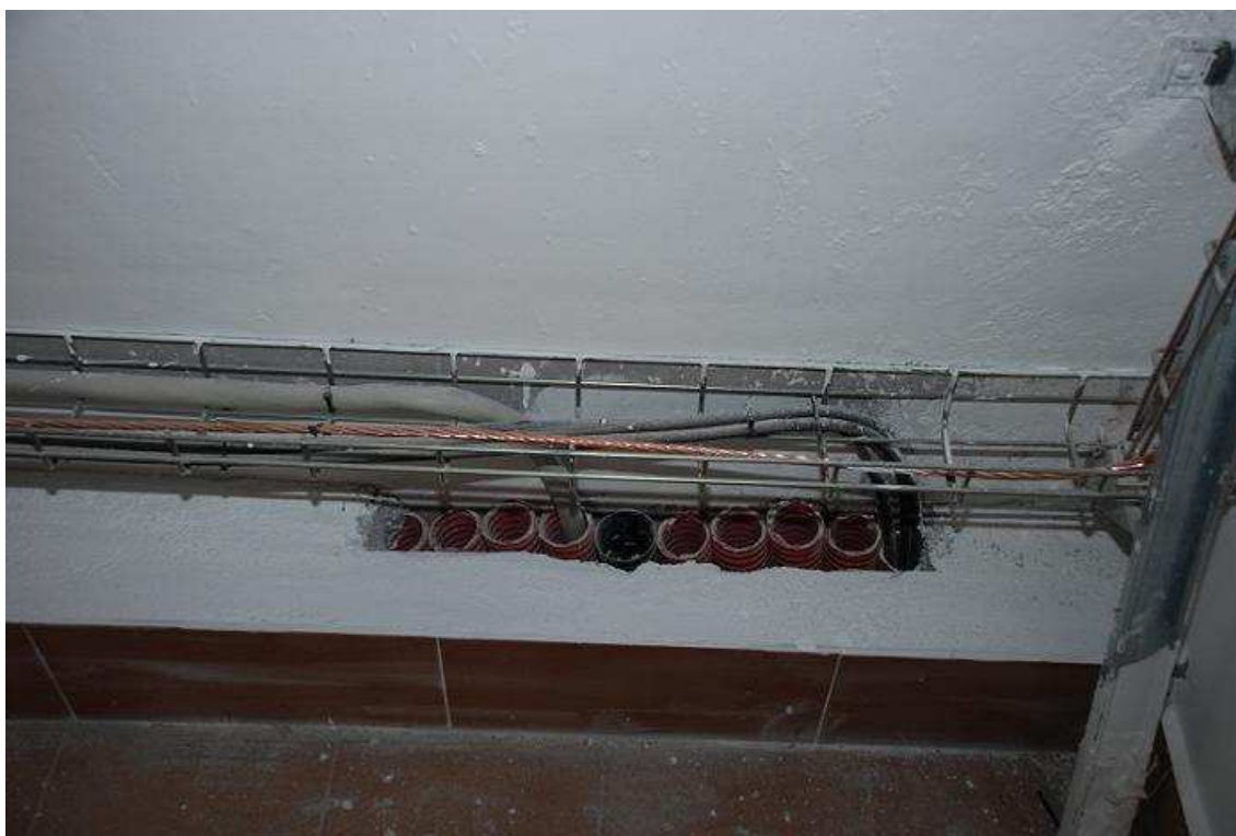
Ejemplo de canalización externa
