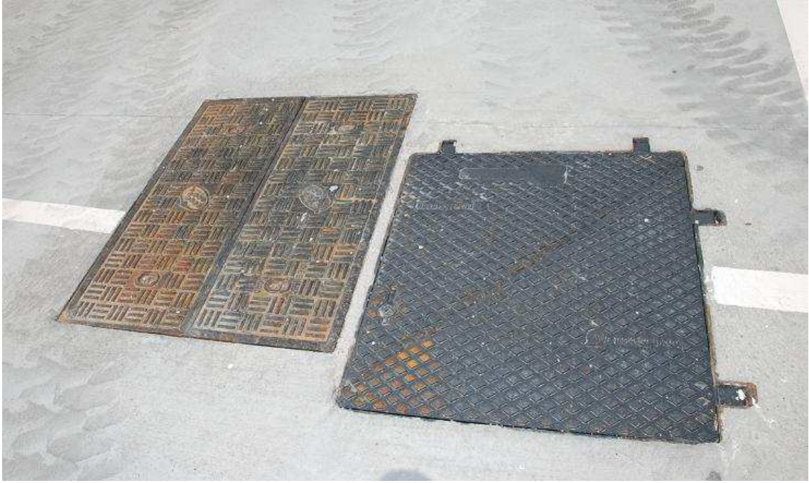
Arqueta de entrada tapada
