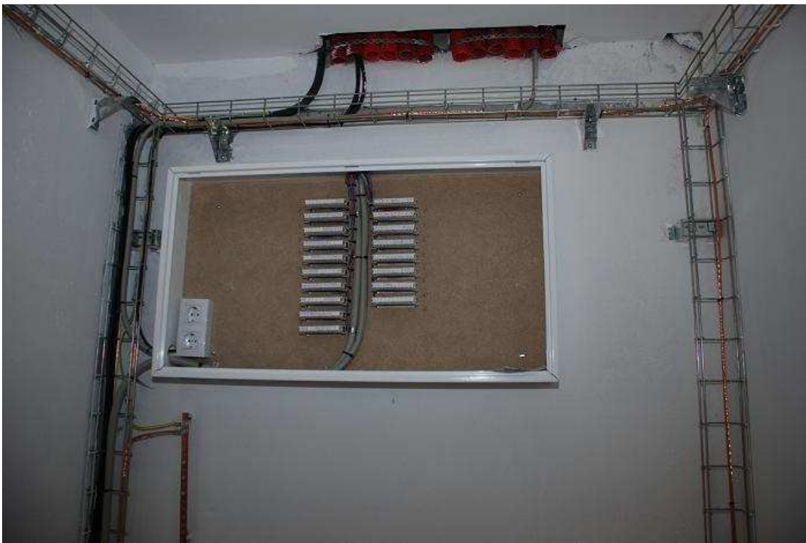
Recinto de Instalaciones de Telecomunicaciones Inferior
