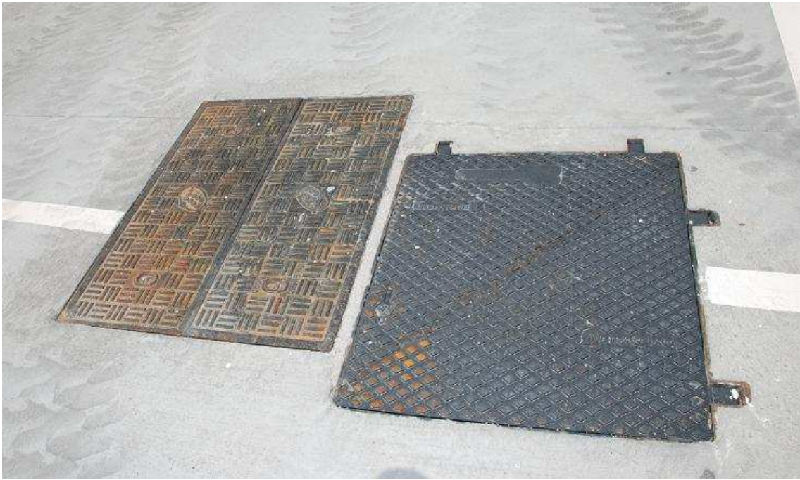
Arqueta de entrada de operadores
