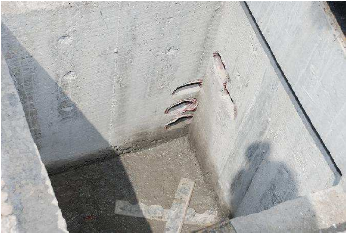
Arqueta de entrada sin tapar
