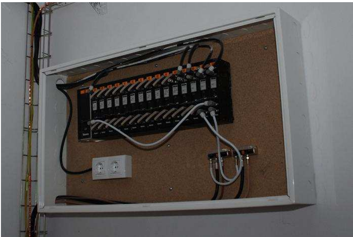
Recinto de Instalaciones de Telecomunicaciones Superior
