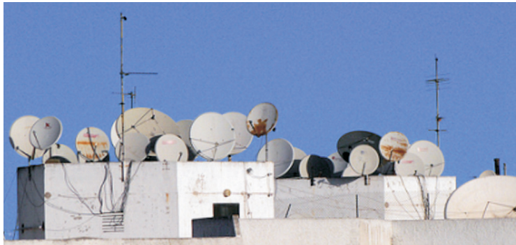
Fig. 1.1. Acumulación de antenas y cables en el tejado de un edificio.
