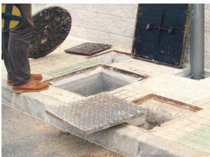
Fig. 1.4. Arqueta para telecomunicaciones.
